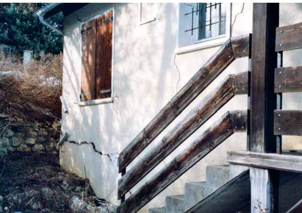
Fissurations importantes d'une maison implantée sur le glissement
