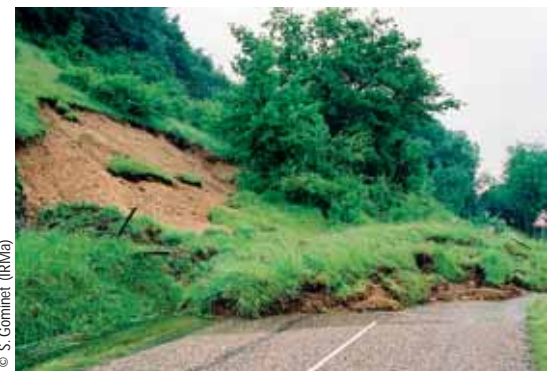
Glissement plan sur la RD 28 sur la commune de Merlas (Isère) à la suite des fortes précipitations du 6 juin 2002
